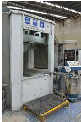
TÚNEL DE PINTURA ELECTROSTÁTICA
